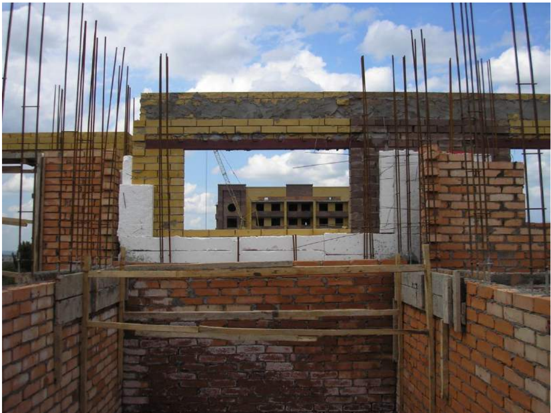
Рисунок 1.8 – Фрагмент многослойной стены в области оконного проема 10-ти этажного дома в г. Черкеске
