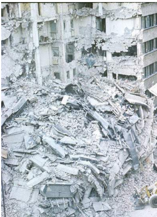
Рисунок В.1 – Разрушение кирпичного многоэтажного жилого дома в результате Румынского землетрясения 1977 года
